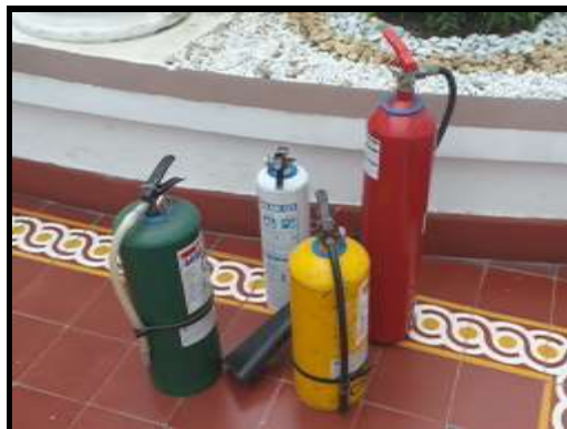
Recarga de extintores
